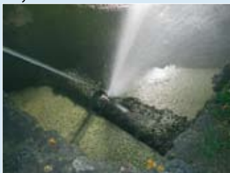
Typická prasklá vodovodní trubka
